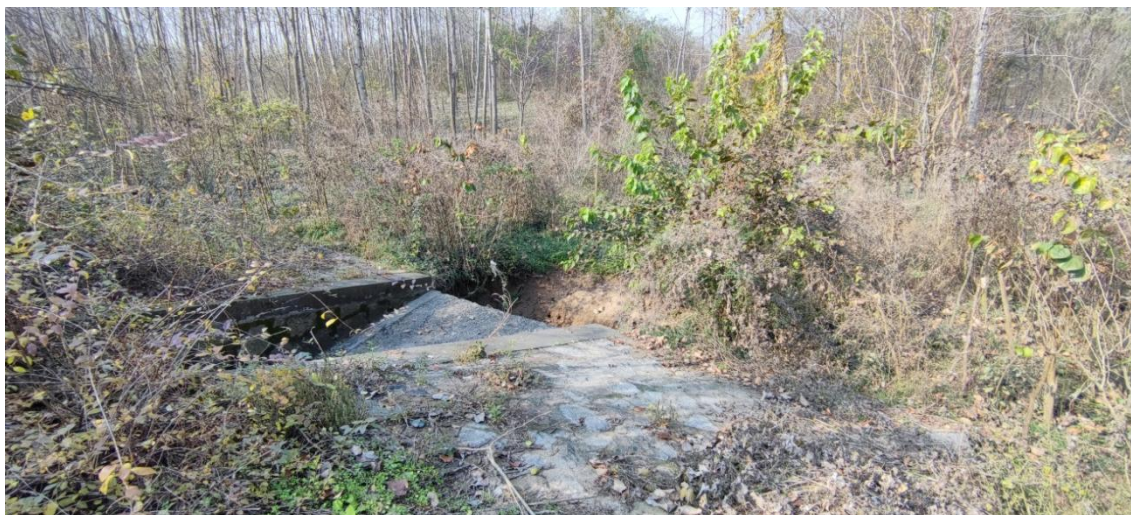
图 3.2-22 段口站出水侧涵洞
