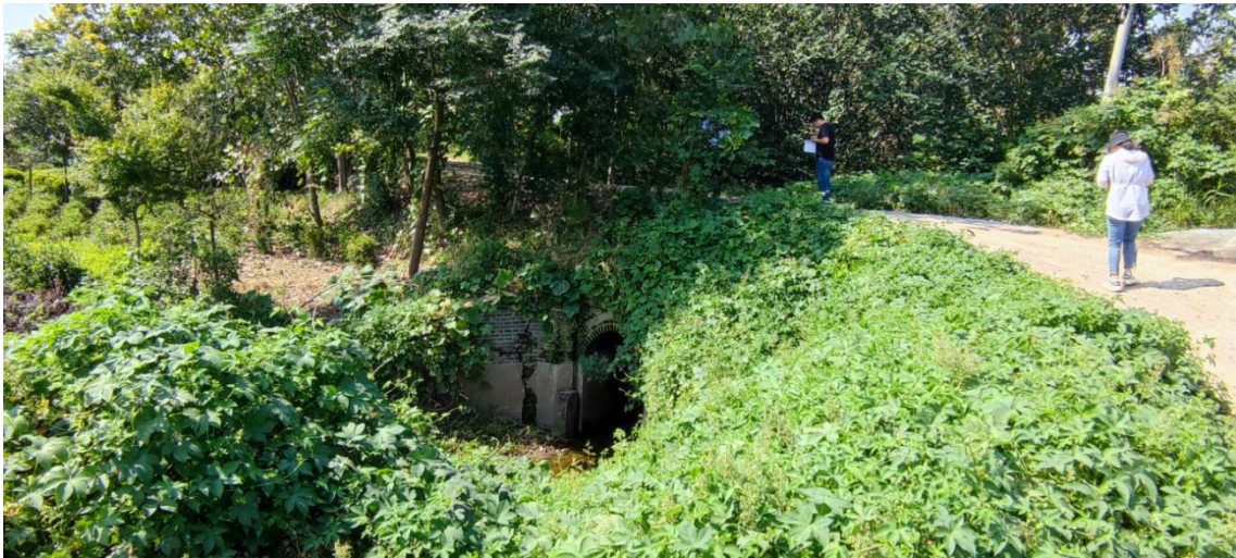
图 3.2-41 花晏圩东闸主体结构破损严重，危及堤防安全
