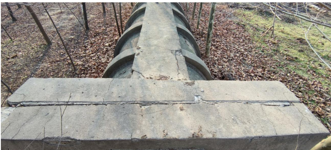
图 3.2-15 项宅站破损的出水涵洞
