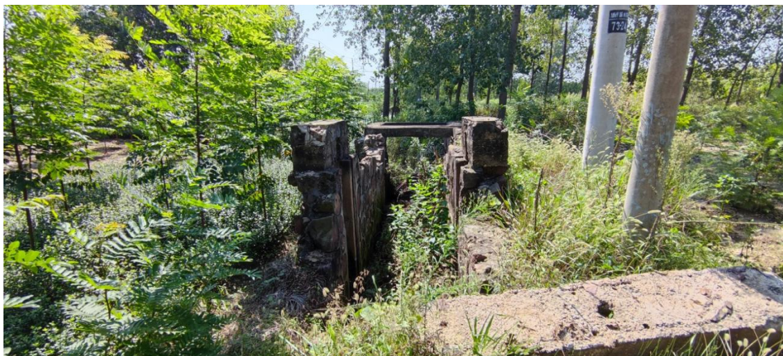
图 3.2-37 周圩中沟闸主体结构损坏严重，功能丧失
