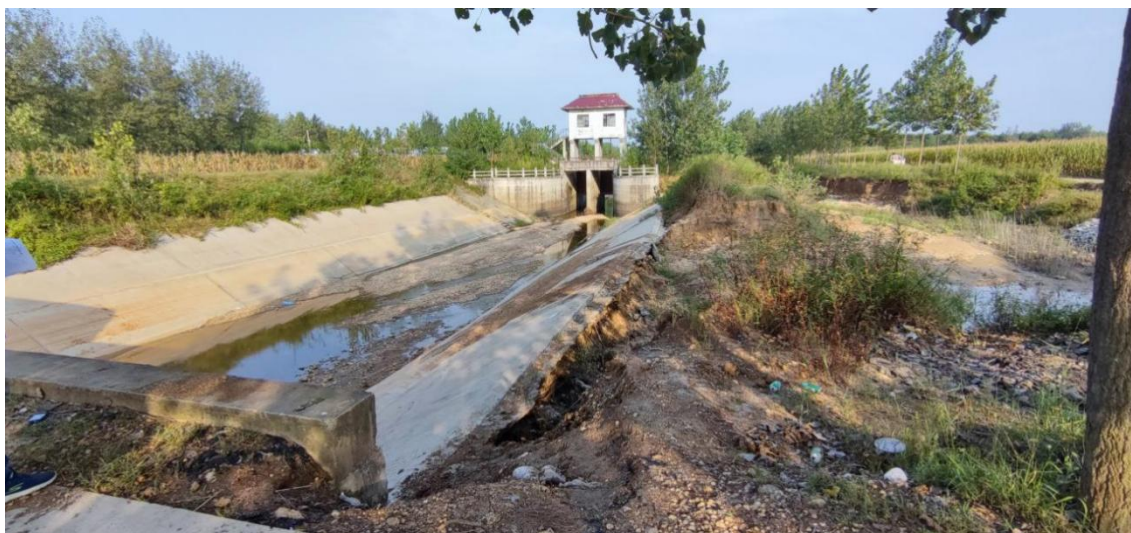
图 3.2-36 马岭防倒灌闸右岸防护结构被冲毁
