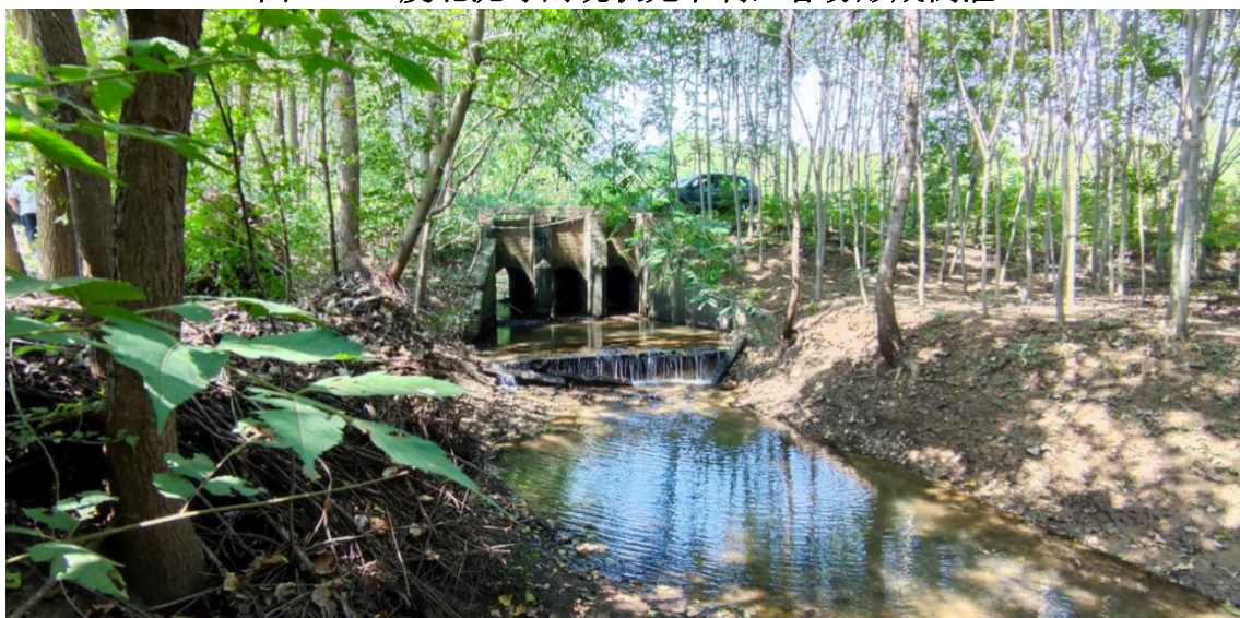
图 3.2-40 项宅退水闸现状无节制，容易形成倒灌
