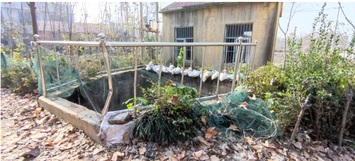
图 3.2-26 徐口站出水池侧现状（池顶高程不足）
