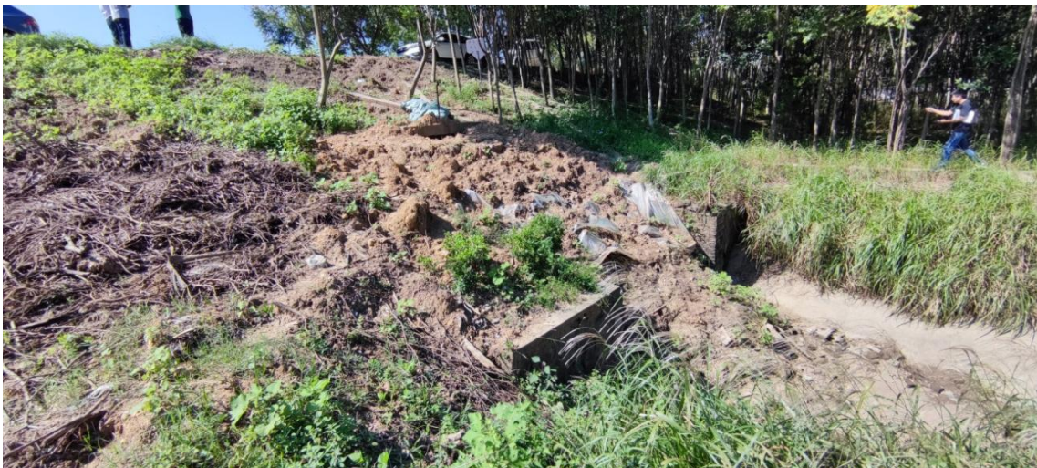
图 3.2-43 贯勤闸现状无节制，防止倒灌采用黏土封堵
