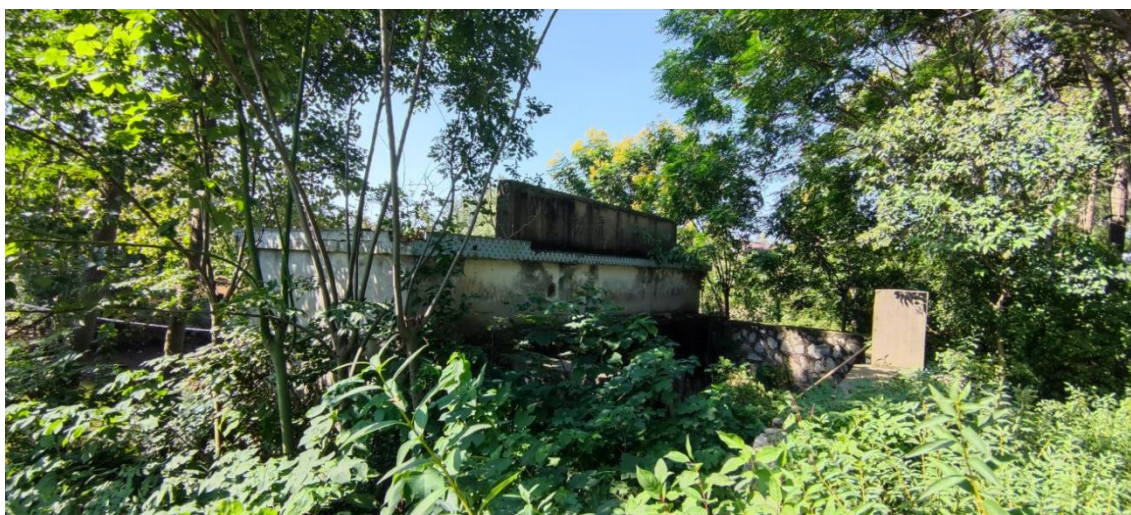
图 3.2-32 贯勤站出水池现状
